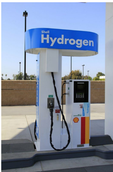
Εικόνα 13. Ο πρώτος σταθμός ανεφοδιασμού υδρογόνου των ΗΠΑ με αγωγό στο Torrance της Καλιφόρνια.
